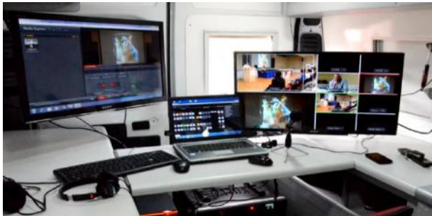
Imagen 34: Monitoreo del Sistema de Radio Comunicación VHF/HF Fuente: Propia
