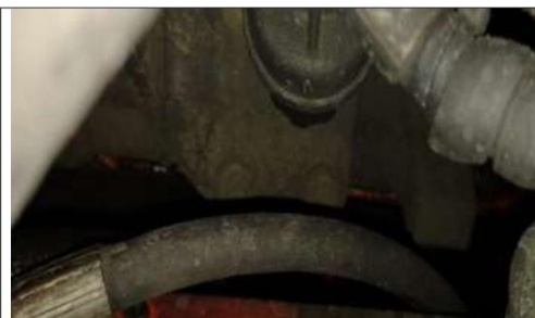
Fuga aceite por cárter de motor diésel.
