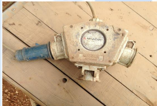
Extensiones electricas deterioradas
