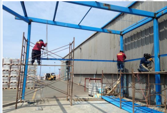
Andamios no autorizado, sin arnés ac
