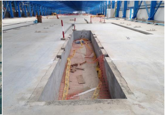
Zanjas sin protección
