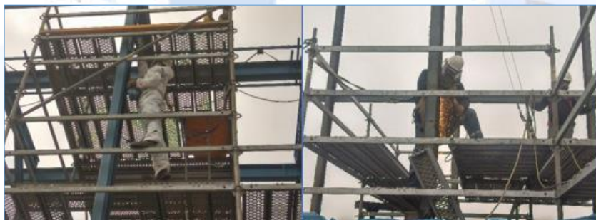
Figura 5. Labores en altura y en caliente sin estándares de seguridad Fuente y Elaboración: Propia, 2018.
