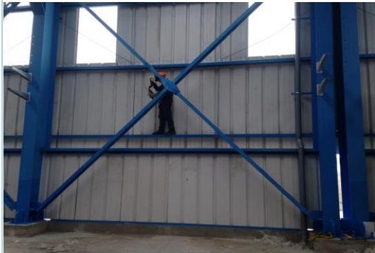
Trabajos en altura sin arnés anticaída
