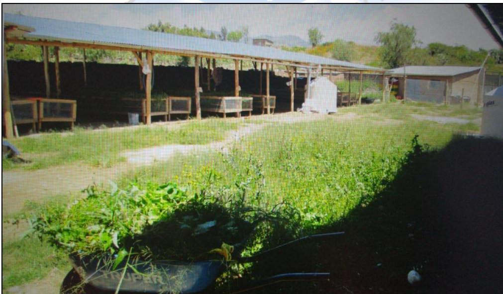
Figura 5. Deficiencias en la distribución de los ambientes y el contacto con el entorno
