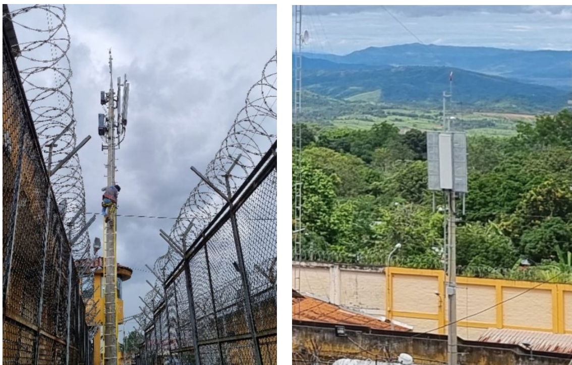
Figura. Instalación de Antenas COMBA en E.P.
